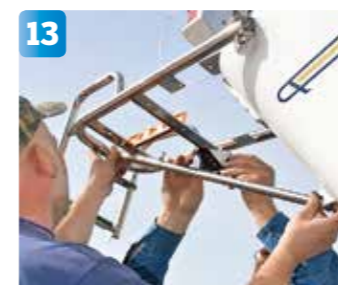
13 Dock ska vinkeln på peket bli rätt samtidigt som staget inte hamnar helt fel. Vattenpasset behövs i alla fall för att få peket vågrätt.
