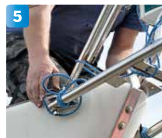
5 Det ska inte bara sitta i rätt vinkel i förhållande till däckets förlängning, det måste dessutom sitta rakt i förhållande till bordläggningen på bägge sidor.
