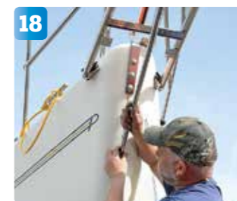
18 Sedan är det bara att skruva dit alltihop med hjälp av en medhjälpare på insidan.
